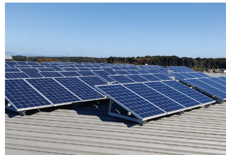
コユールンティアが関東エリアセンターに設置した自家消費太陽光発電設備
