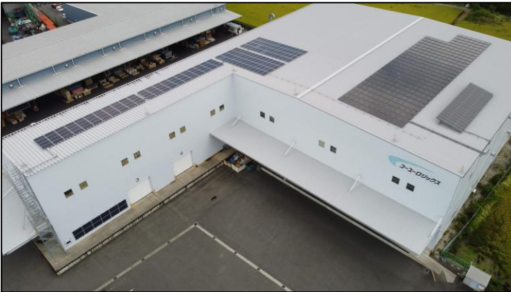
中部エリアセンター 屋上 リユースパネル
